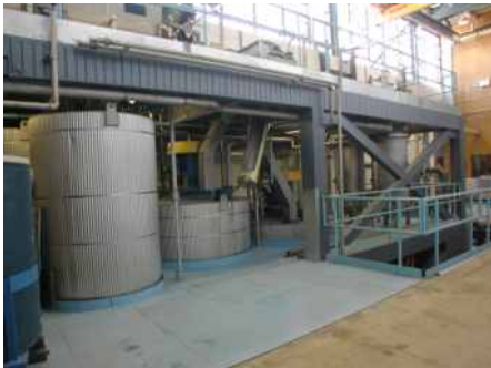
La versatilité de l'ensemble des réservoirs permet le fonctionnement continu de l'usine et l'évaluation des stratégies de pointe pour le recyclage des filtrats.
